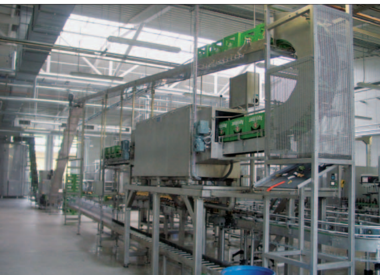
Die Leergebinde werden von einer Brücke kommend über einen Abwärtsförderer zum Auspacker und danach wieder über einen Aufwärtsförderer auf eine Rollbahn geleitet, den ersten C-Wender passierend erreichen sie die Kastenwaschanlage.
