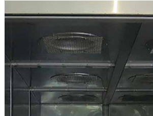
Große Ventilatoren im Innenraum
