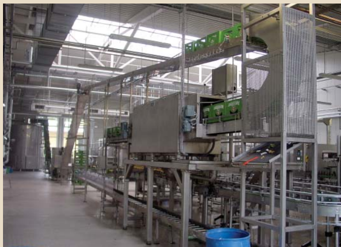
Abb. 3 Transport der Leergebinde von einer Brücke über einen Abwärtsförderer zum Auspacker, über einen Aufwärtsförderer auf eine Rollbahn, über den ersten C-Wender bis zur Kastenwaschanlage
